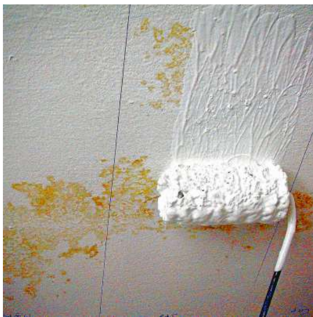
Falsch: Wer meint, dass nach einem Wasserschaden im Haus eine einfache Schönheitsreparatur ausreicht, der irrt. Die Folgeschäden können erheblich sein, wenn sich die Nässe im Mauerwerk einnistet.
