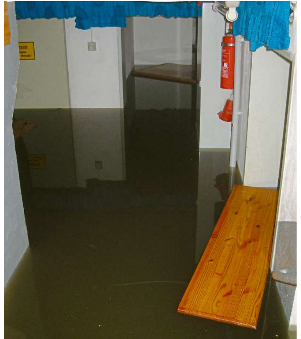
Wenn das Wasser im Keller so hoch gestanden hat, ist eine gründliche Sanierung nicht mehr zu umgehen.
